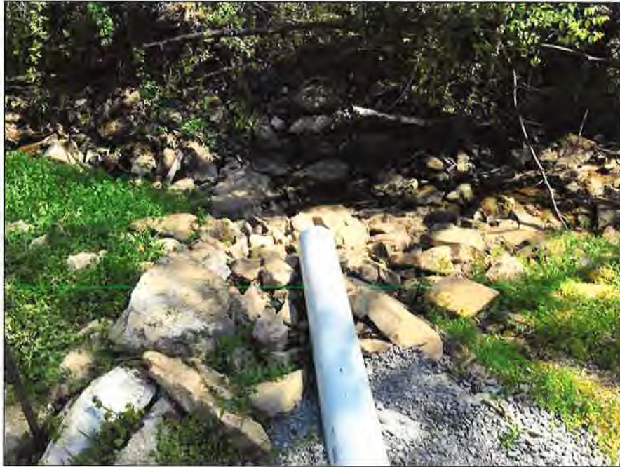
Effluent Discharge Pipe
